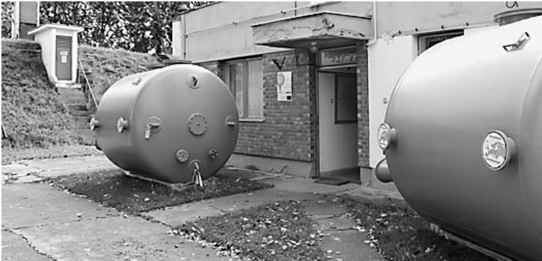
Már a vízműtelepen várják a beépítésüket az új szűrőtartályok
